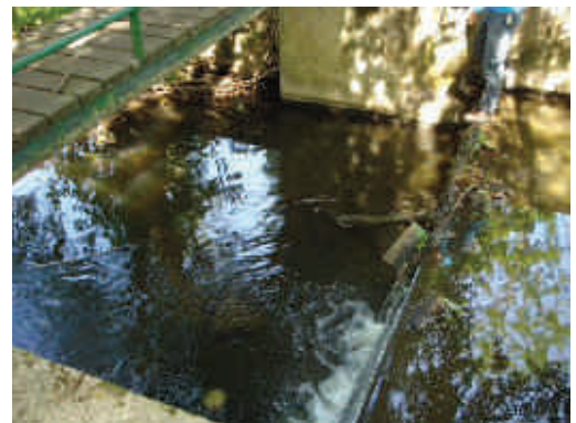
Photo au niveau de la vanne à Favières
